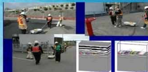
墾丁消防地下管線定位檢測
